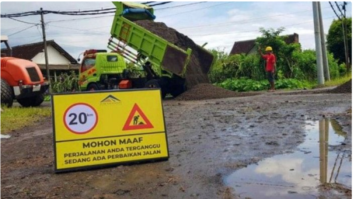
Perbaiki jalan rusak di Banyuwangi
